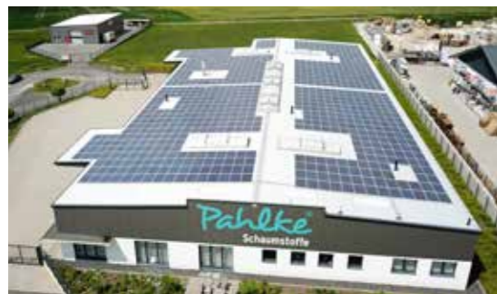
Unsere im Mai 2019 in Betrieb genommene Photovoltaikanlage.
